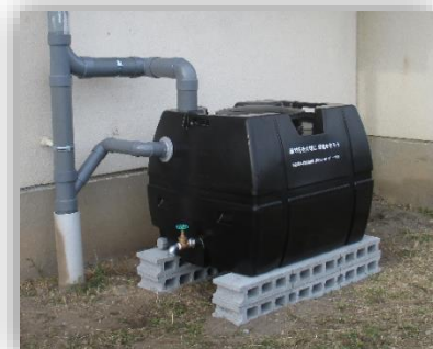
(雨水貯留タンク)
