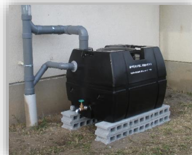
(雨水貯留タンク)
