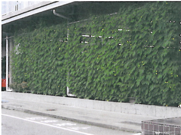
事務所南側窓一面を覆う緑のカーテン
