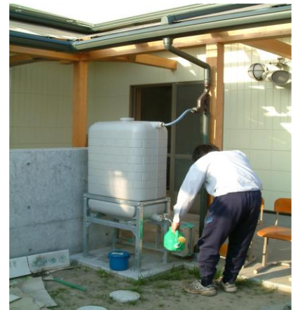
（雨水貯留タンク）
