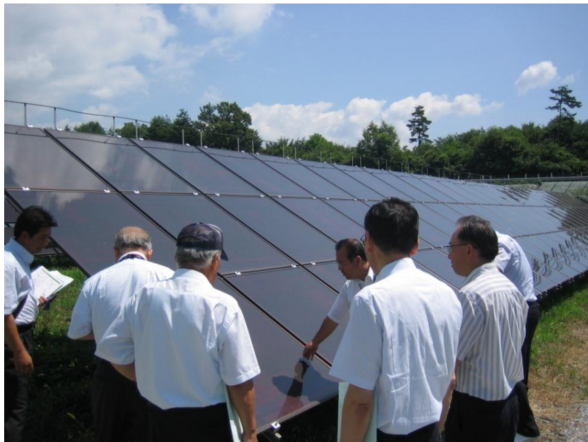
北杜サイト太陽光発電所
