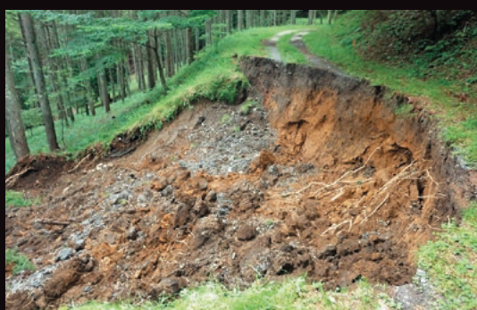
横川山 林道堤洞線路肩崩落
