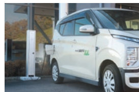
EVカー・充電設備
