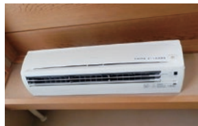
▲エアコン（東堀区）
