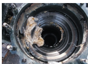
マンホールポンプのなかでからまった布
