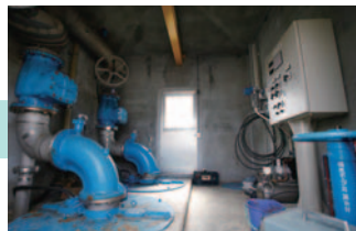
⑤原水ポンプ井
