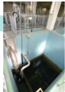
⑩急速ろ過池
