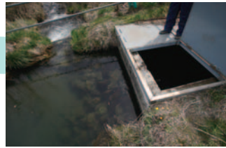
②取水流入弁+導水管
