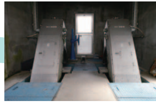
③除じん機室
