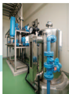
⑪真空タンク・真空ポンプ
