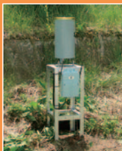
新しく設置された雨量計
