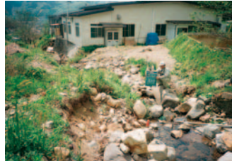
被災後(着手前)
