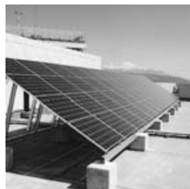
▲太陽光発電システム (イルフプラザ屋上)
