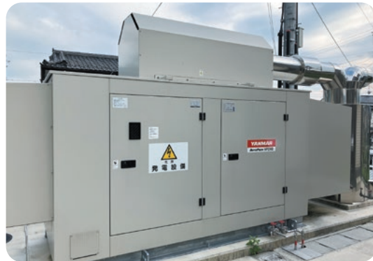
宗平寺水源の自家発電設備
