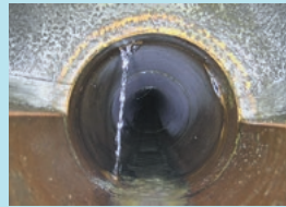
管のひび割れから水が浸入
