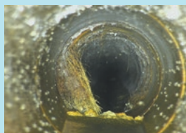
樹木根の侵入
