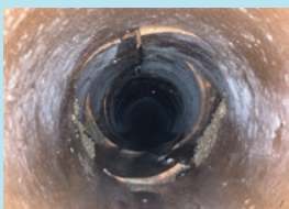
白く見える筋がひび割れ
