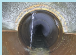
管のひび割れから水が浸入
