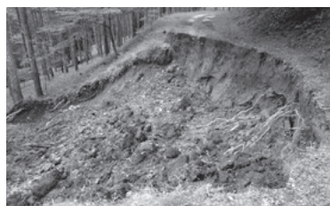
令和3年8月 横川山 林道堤洞線路肩崩落
