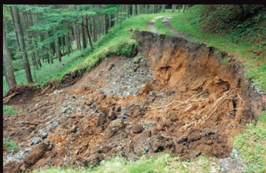
横川山 林道堤洞線路肩崩落
