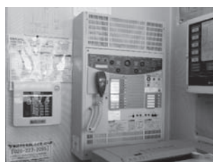
【小口区】非常放送設備など
