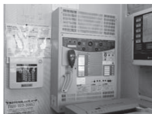
【小口区】非常放送設備など
