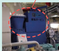
蒸気タービン
