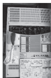
【中屋区】非常用放送アンプ
