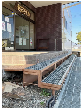
諏訪市豊田公民館の地盤沈下
