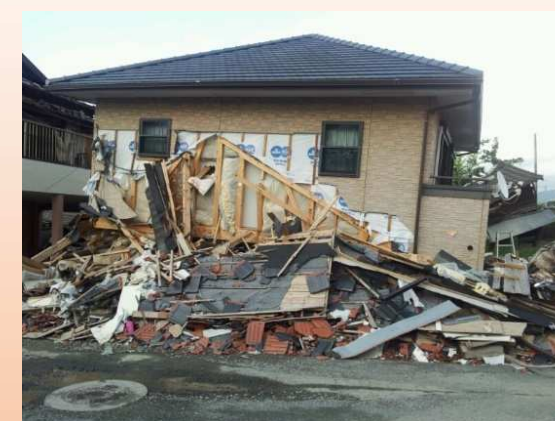
平成28（2016）年熊本地震による被害
