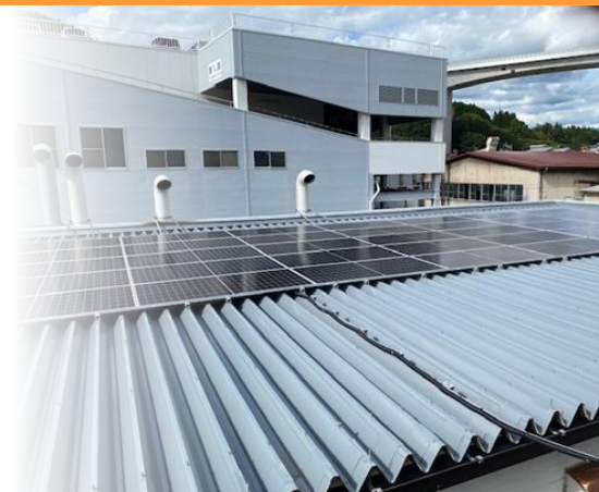
再生可能エネルギーの活用（太陽光パネル）
