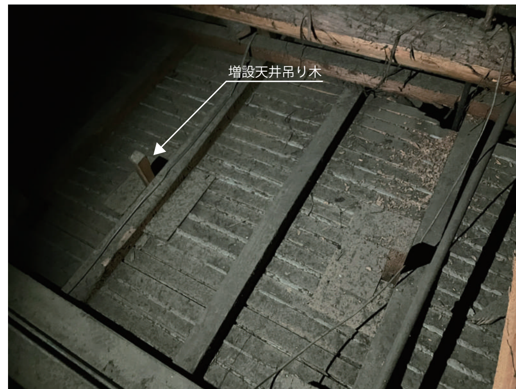
昭和34年に当初天井の下に増設された天井は、小屋組みの構造材から支持をとらず当初天井の仕上げ下地から吊り木を設置している
