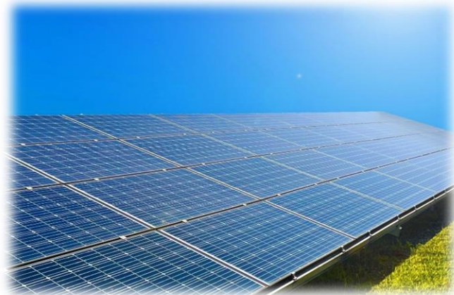
太陽光発電システム
