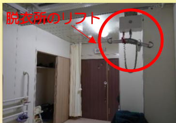
利用者・介護者双方の負担を 軽減するため、施設内には リフトが多く設置されています。
